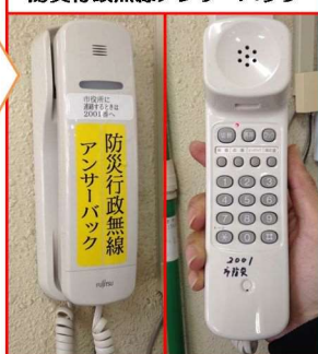
防災行政無線アンサーバック
