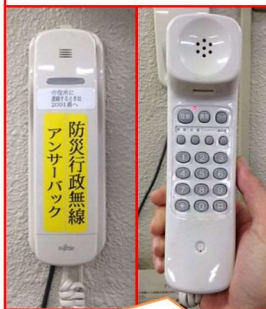
防災行政無線アンサーバック
