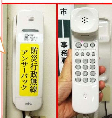
防災行政無線アンサーバック
